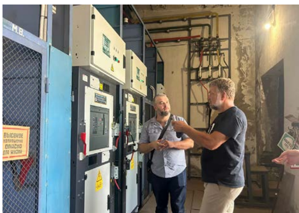
Figur 8: Drøftelse af tekniske udfordringer med installation og vedligehold af nye donationer
